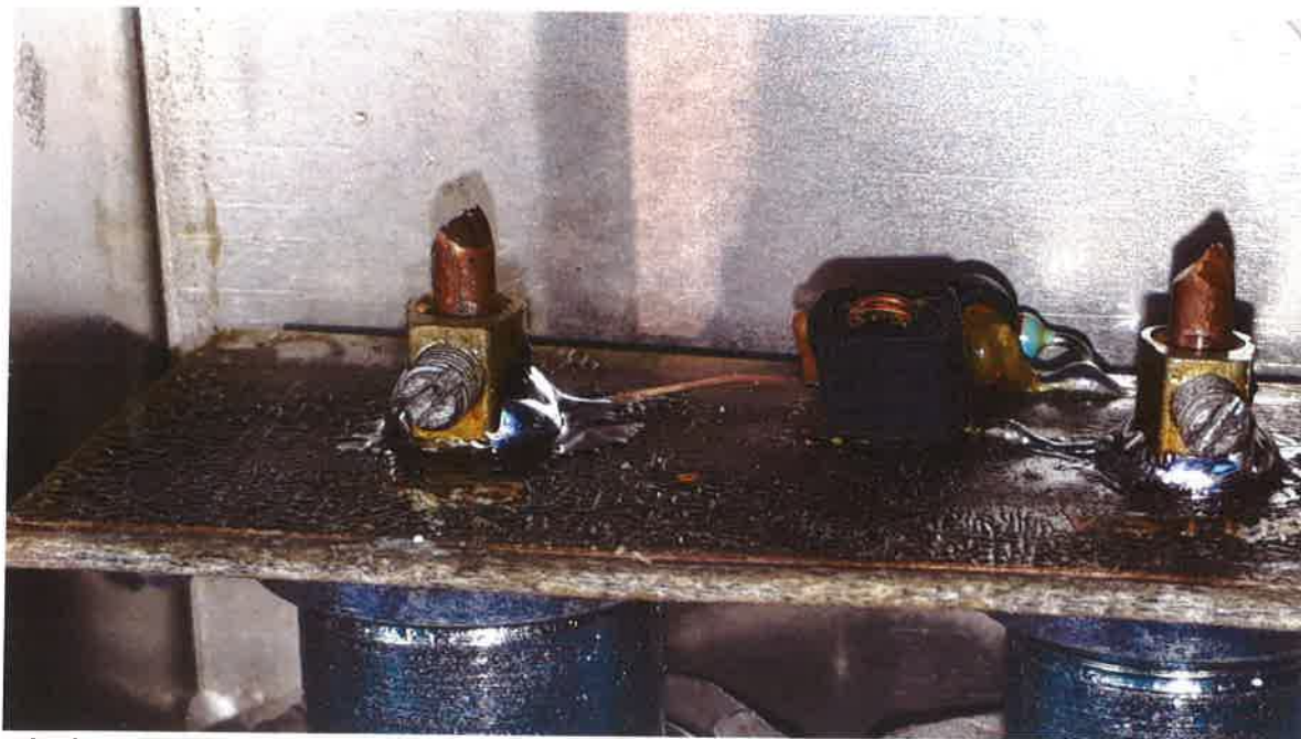
Obrázek 3: Provedená oprava utržené svorkovnice v rozvaděči K181.
